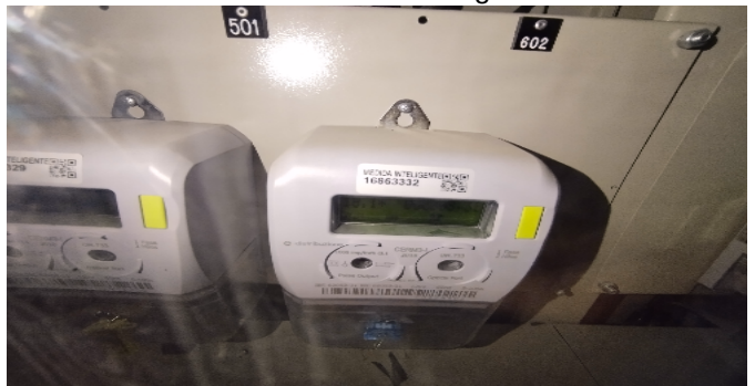
Contador de Energia
