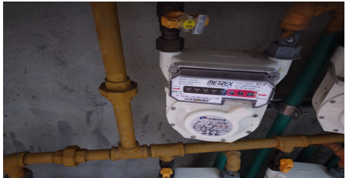
Contador de Gas
