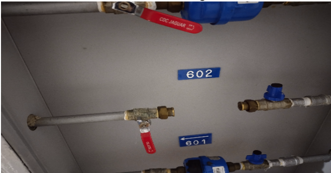
Contador de Agua
