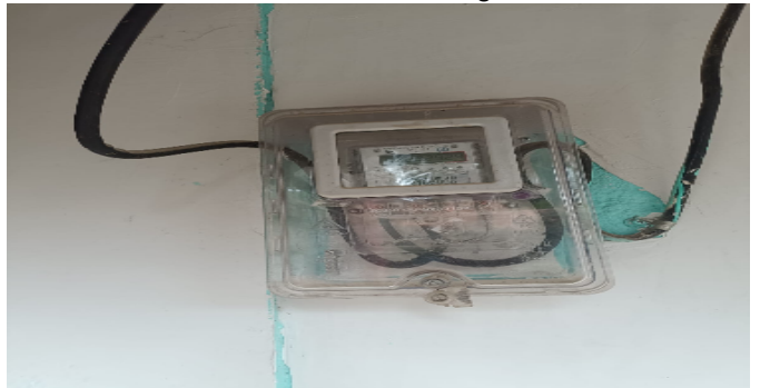
Contador de Energia
