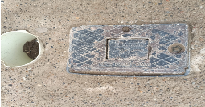
Contador de Agua
