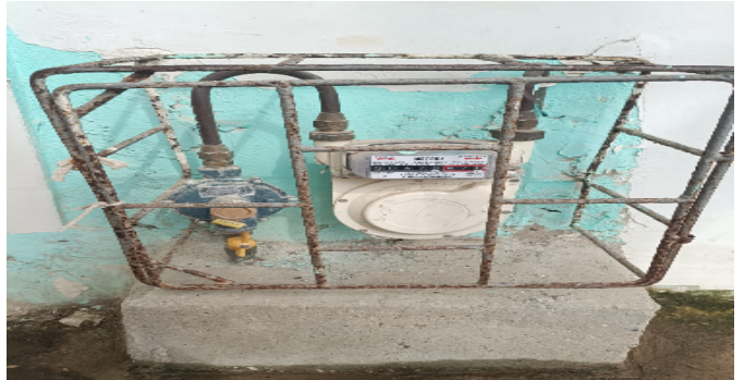
Contador de Gas
