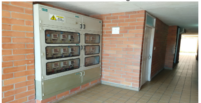
Contador de Energia
