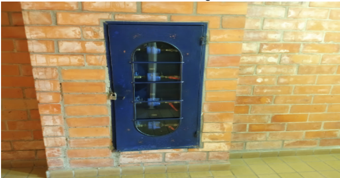
Contador de Agua
