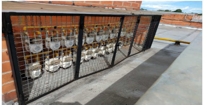
Contador de Gas
