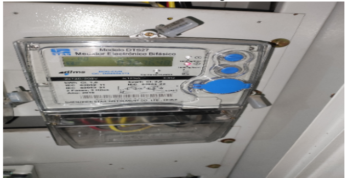
Contador de Energia
