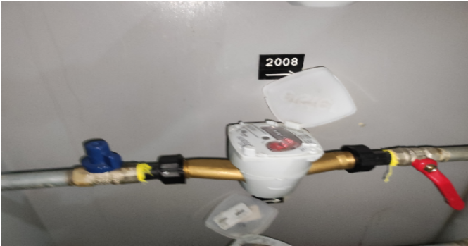
Contador de Agua
