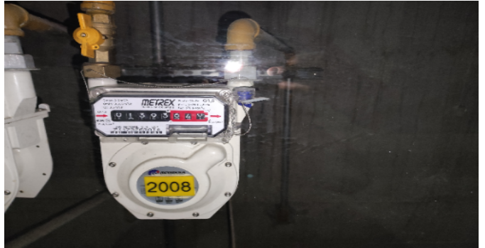
Contador de Gas
