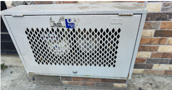
Contador de Gas
