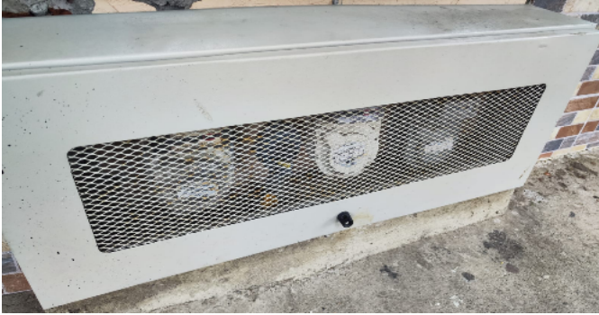
Contador de Gas
