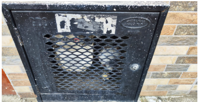
Contador de Gas
