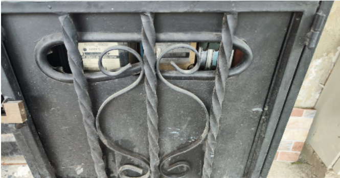
Contador de Energia
