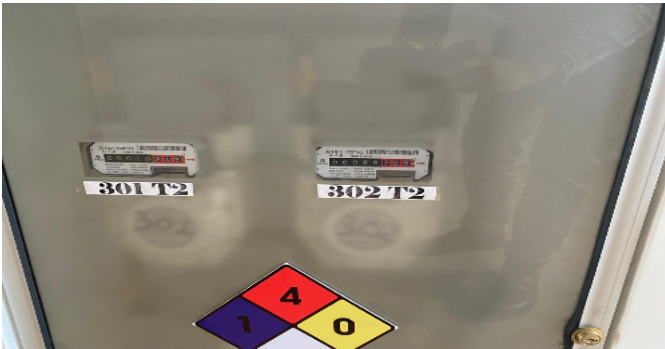
Contador de Gas
