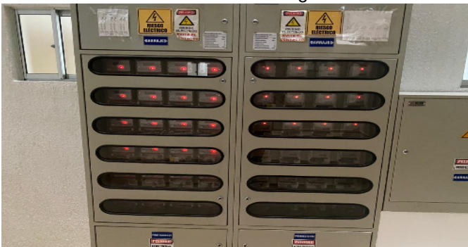
Contador de Energia
