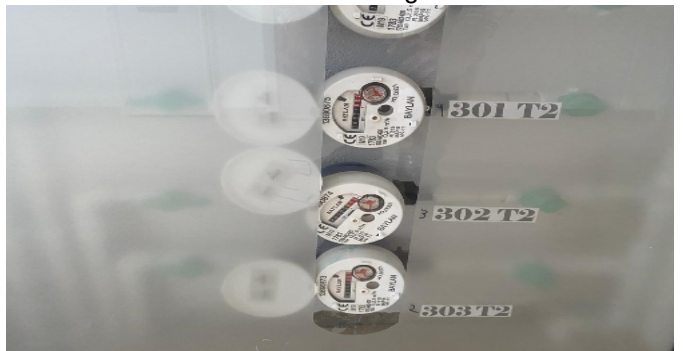
Contador de Agua
