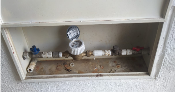
Contador de Agua
