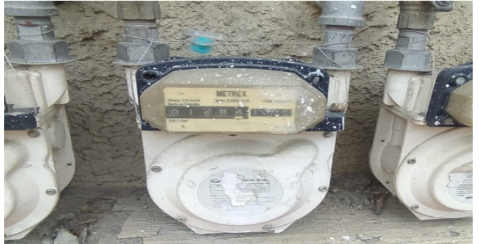
Contador de Gas
