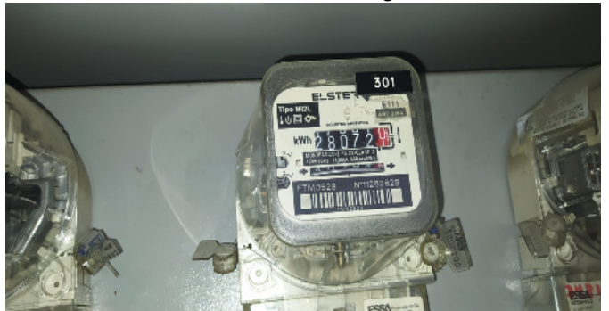
Contador de Energia
