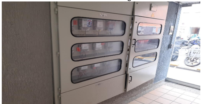
Contador de Energia
