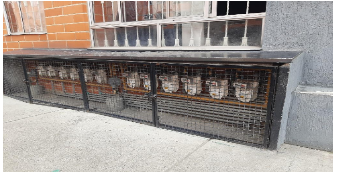
Contador de Gas
