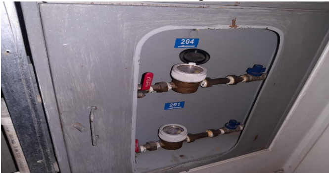
Contador de Agua
