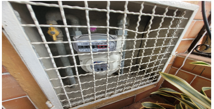
Contador de Gas
