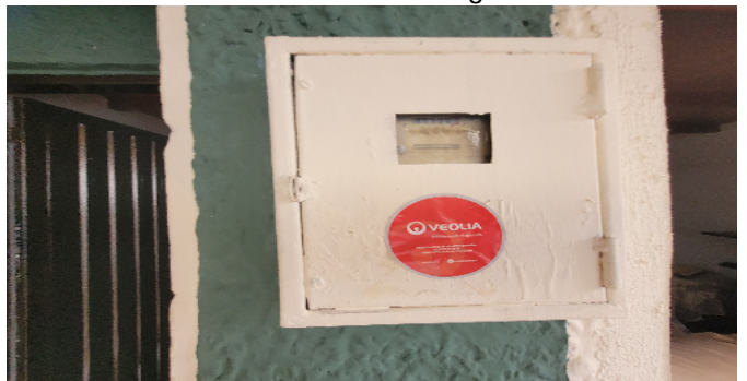
Contador de Energia
