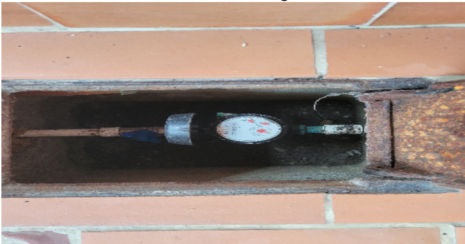
Contador de Agua
