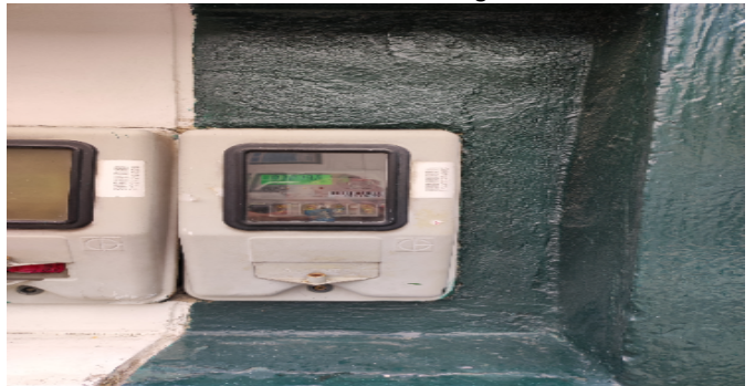
Contador de Energia
