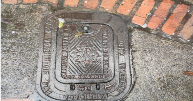
Contador de Agua
