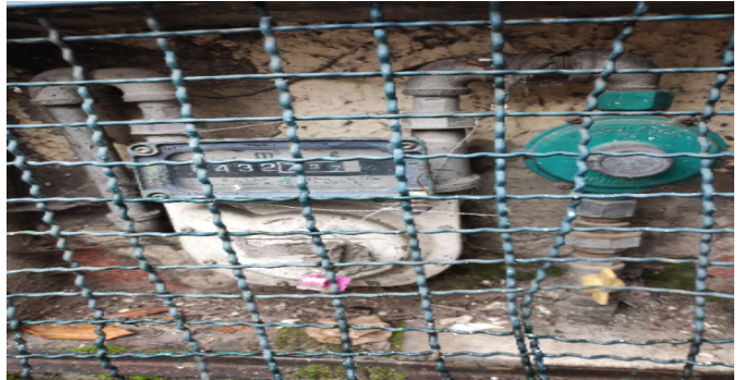
Contador de Gas
