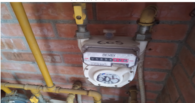
Contador de Gas
