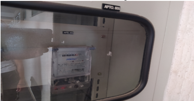
Contador de Energia
