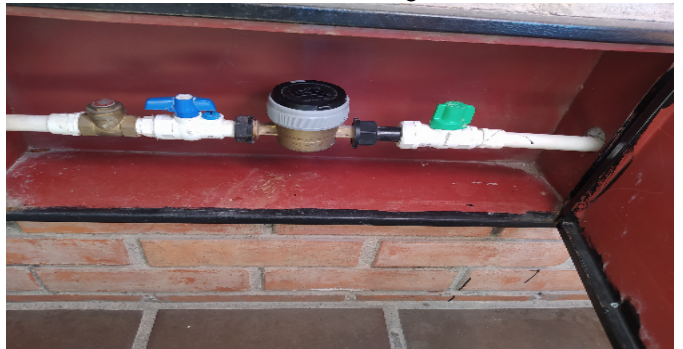
Contador de Agua
