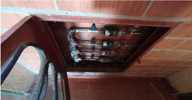
Contador de Agua
