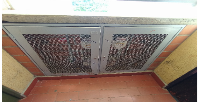
Contador de Gas
