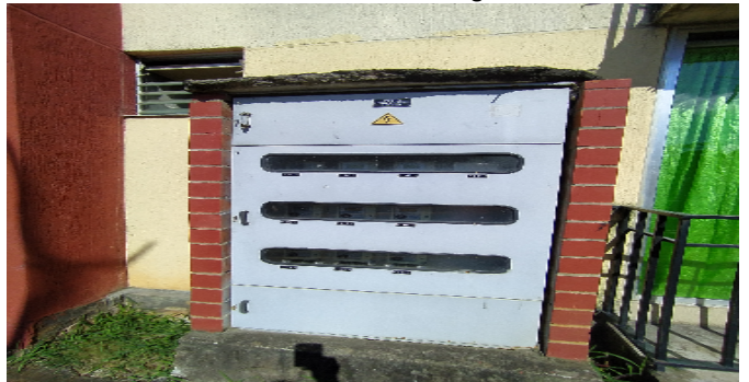
Contador de Energia
