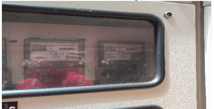
Contador de Energia
