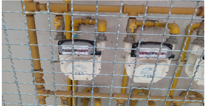
Contador de Gas
