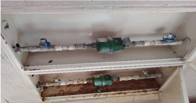
Contador de Agua
