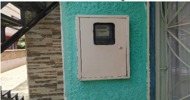
Contador de Energia
