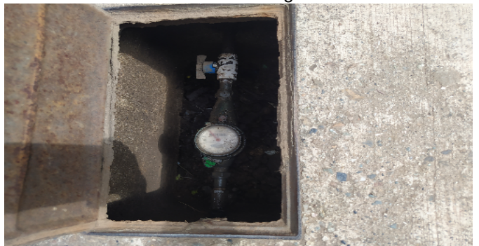
Contador de Agua
