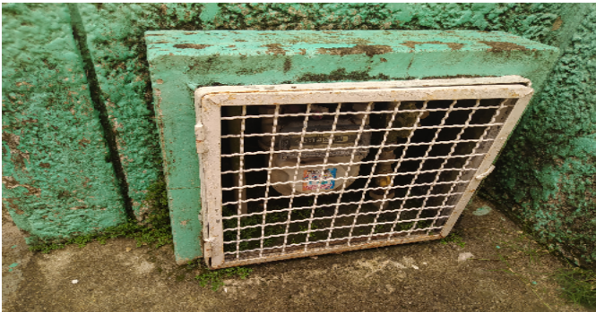
Contador de Gas
