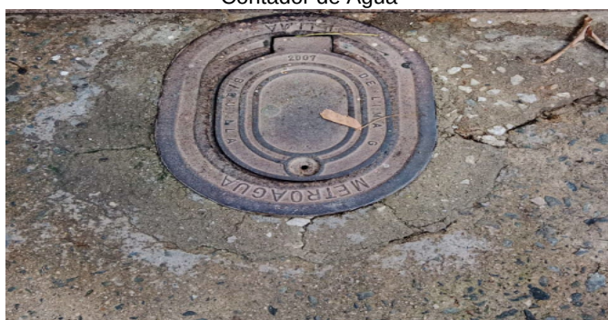
Contador de Agua
