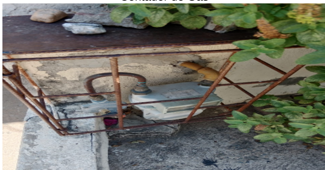
Contador de Gas
