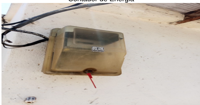
Contador de Energia
