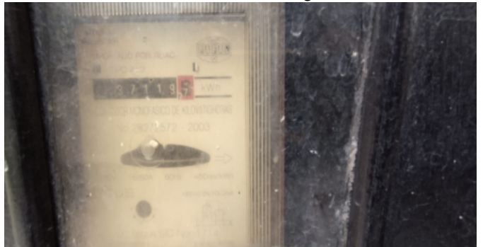
Contador de Energia
