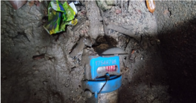
Contador de Agua
