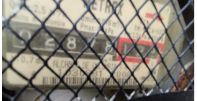
Contador de Gas
