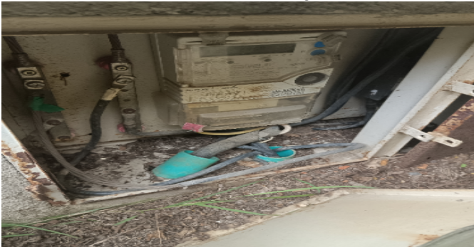
Contador de Energia
