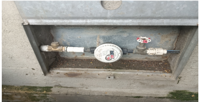
Contador de Agua
