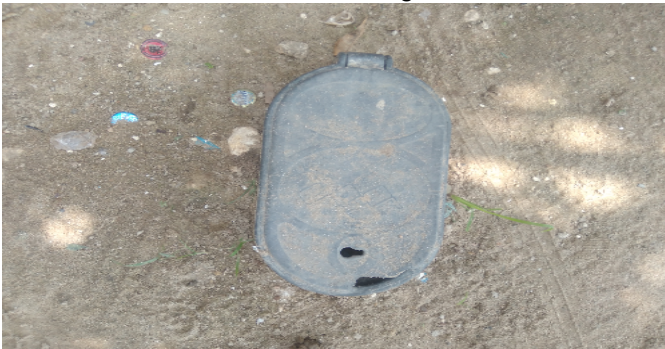
Contador de Agua
