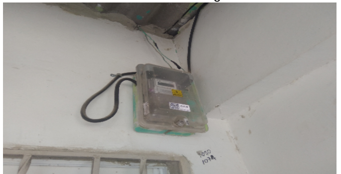
Contador de Energia
