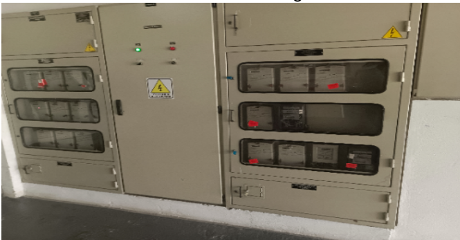
Contador de Energia
