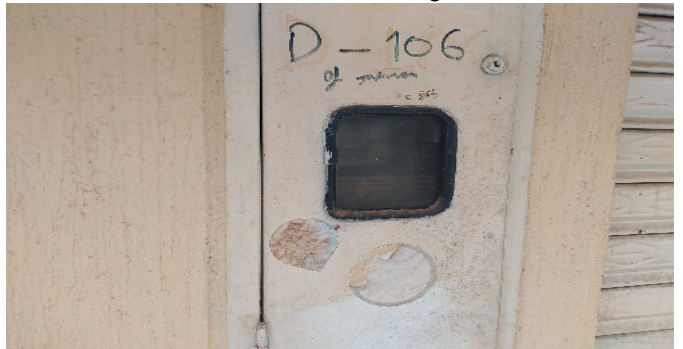
Contador de Energia
