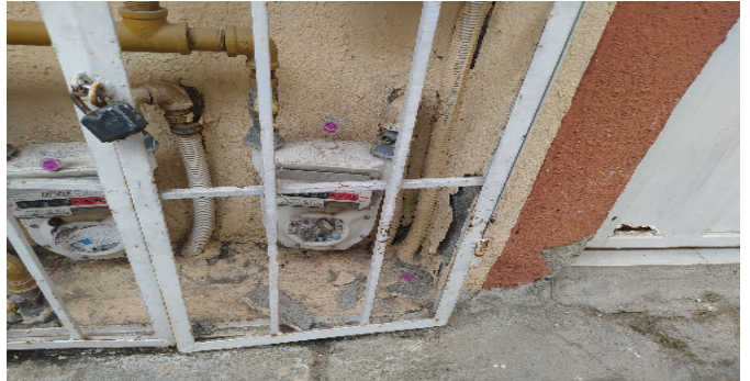
Contador de Gas
