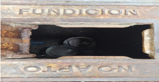
Contador de Agua
