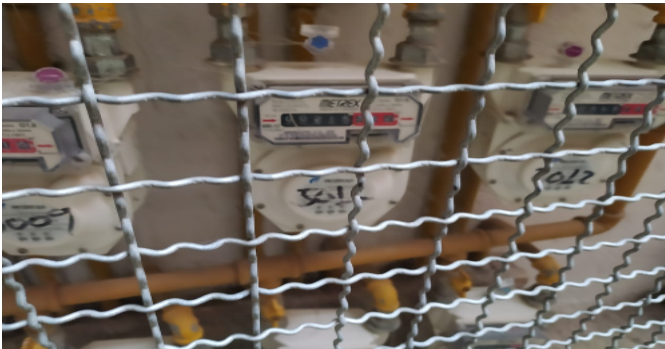
Contador de Gas
