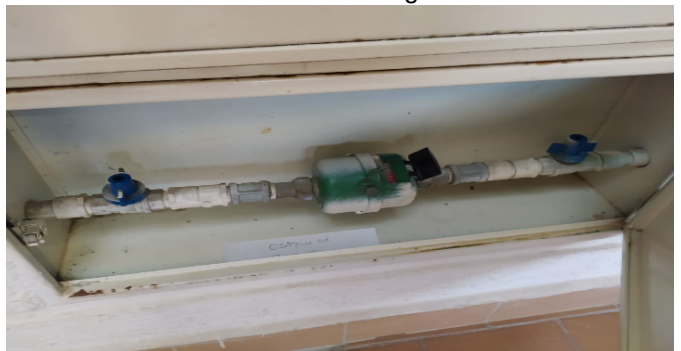
Contador de Agua
