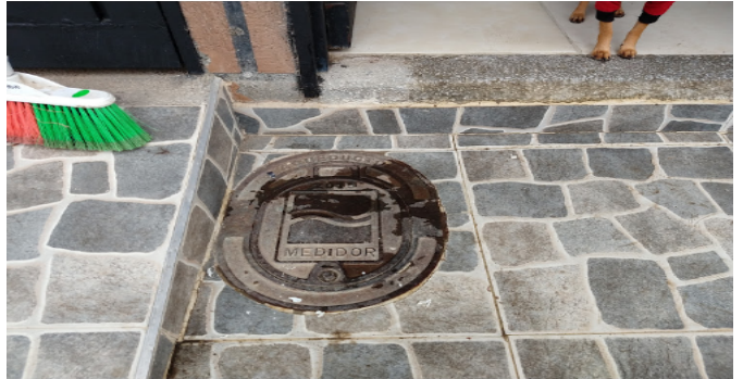
Contador de Agua
