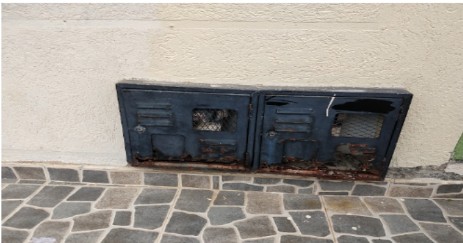
Contador de Gas
