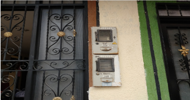
Contador de Energia
