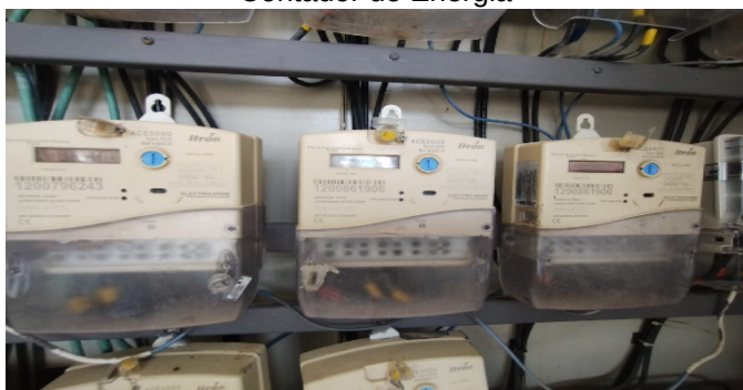
Contador de Energia
