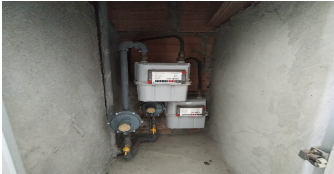
Contador de Gas
