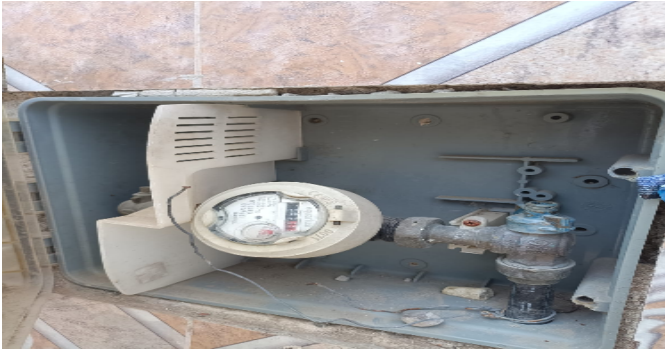
Contador de Agua
