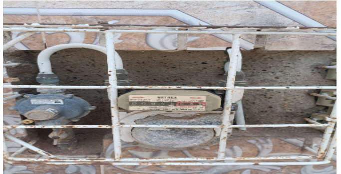
Contador de Gas
