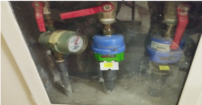
Contador de Agua
