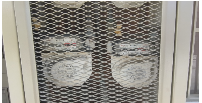
Contador de Gas
