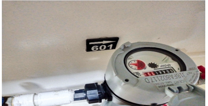
Contador de Agua
