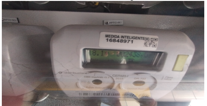
Contador de Energia
