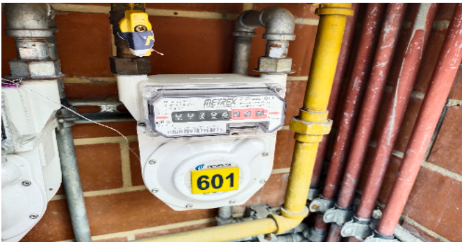
Contador de Gas
