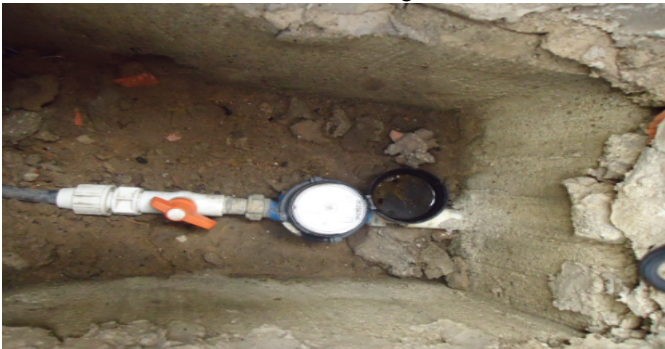
Contador de Agua
