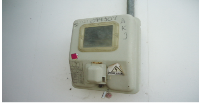
Contador de Energia
