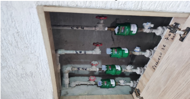
Contador de Agua
