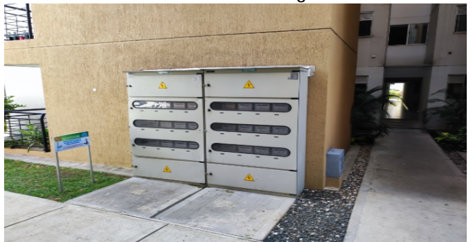
Contador de Energia
