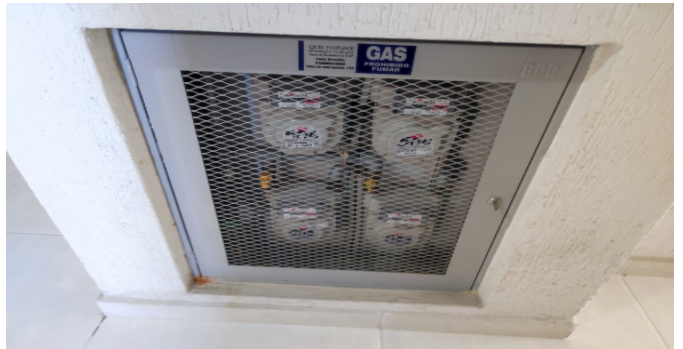
Contador de Gas
