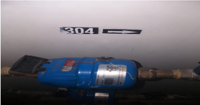
Contador de Agua
