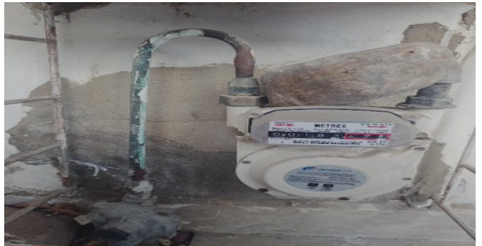
Contador de Gas
