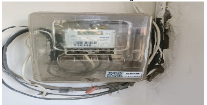
Contador de Energia
