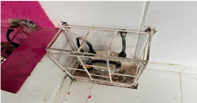
Contador de Gas
