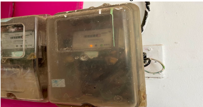
Contador de Energia
