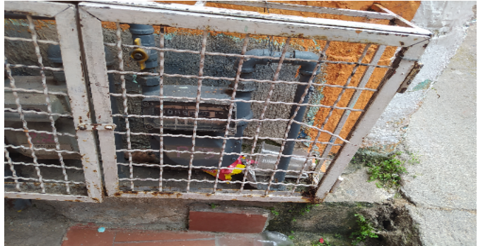
Contador de Gas
