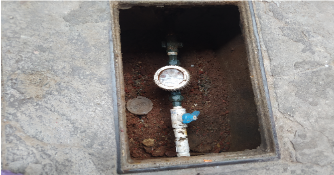
Contador de Agua
