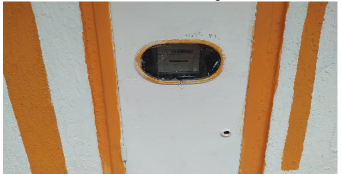
Contador de Energia
