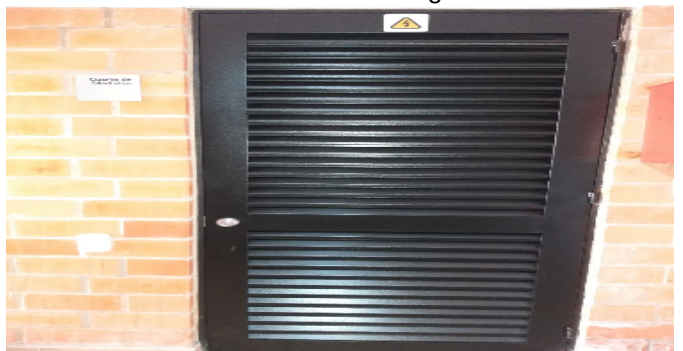
Contador de Energia
