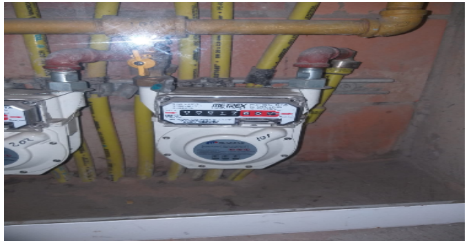
Contador de Gas
