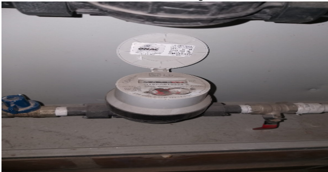
Contador de Agua
