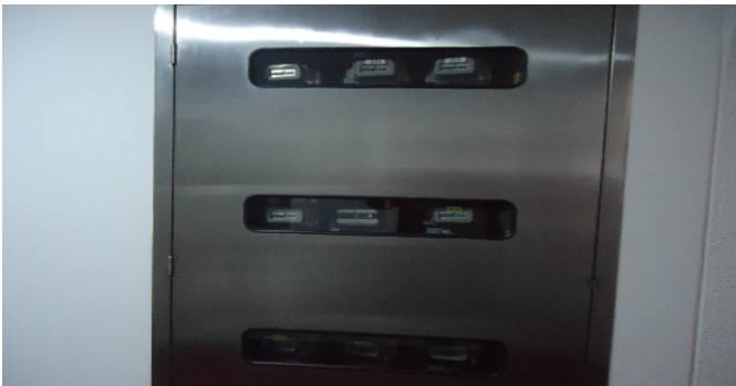
Contador de Gas
