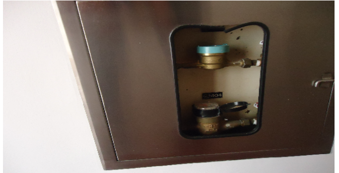
Contador de Agua
