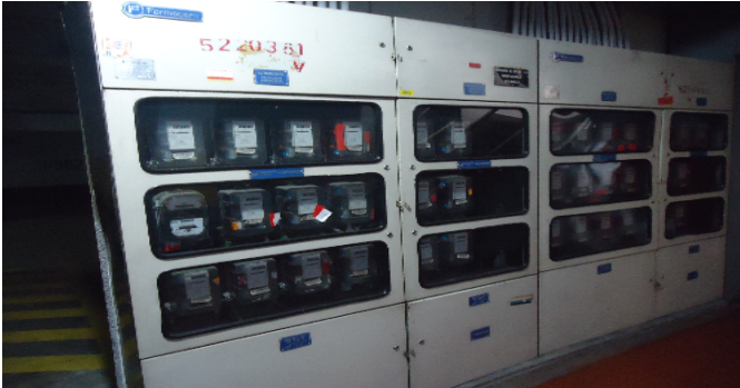
Contador de Energia
