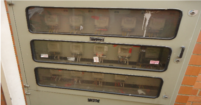
Contador de Energia
