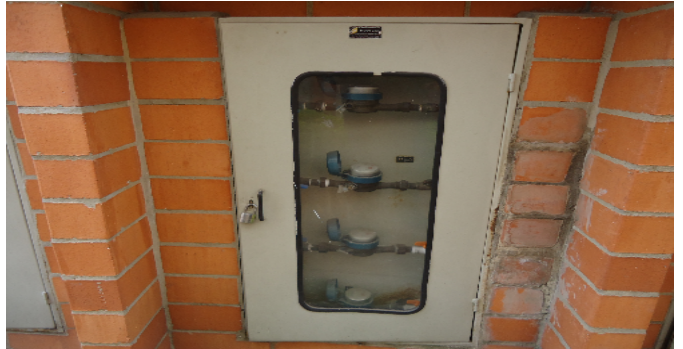
Contador de Agua
