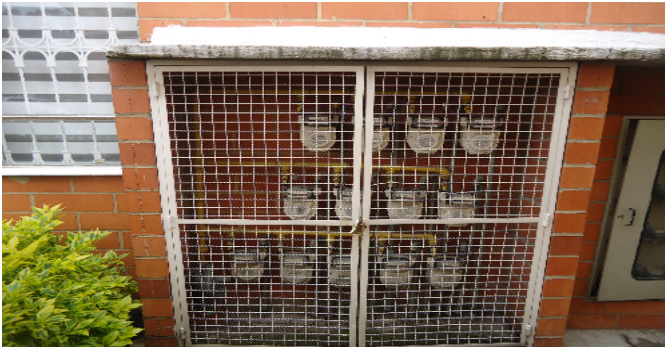
Contador de Gas
