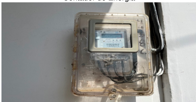
Contador de Energia
