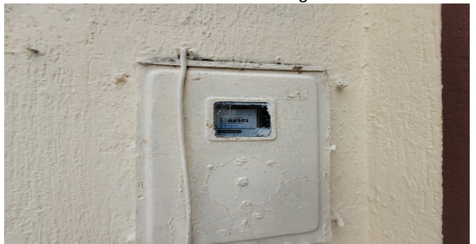
Contador de Energia
