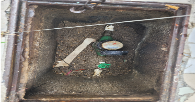
Contador de Agua
