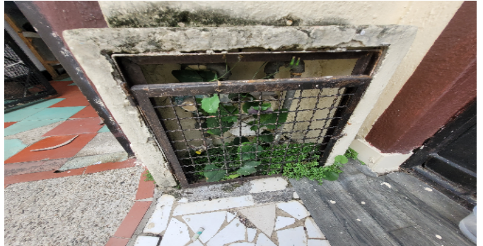
Contador de Gas
