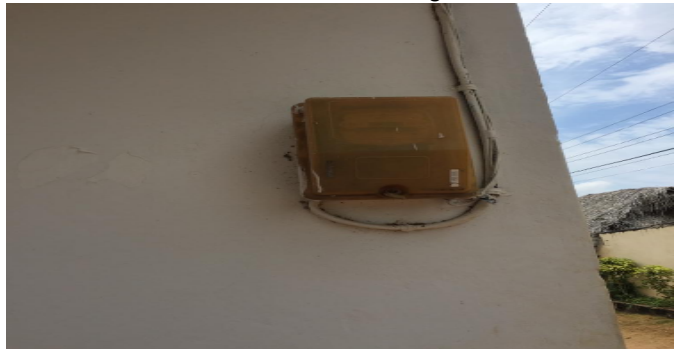
Contador de Energia
