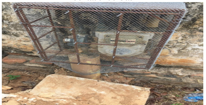
Contador de Gas
