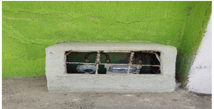
Contador de Gas
