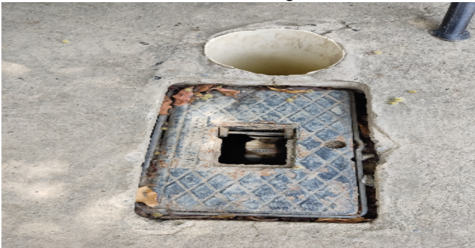
Contador de Agua
