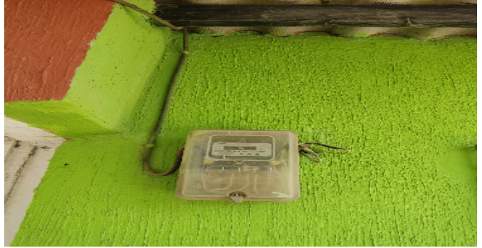
Contador de Energia
