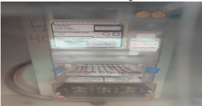
Contador de Energia
