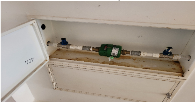
Contador de Agua
