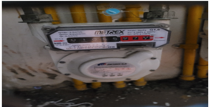
Contador de Gas
