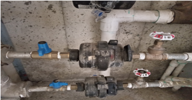
Contador de Agua
