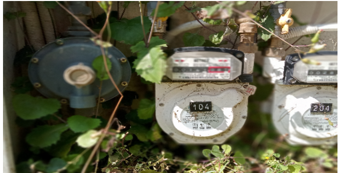
Contador de Gas
