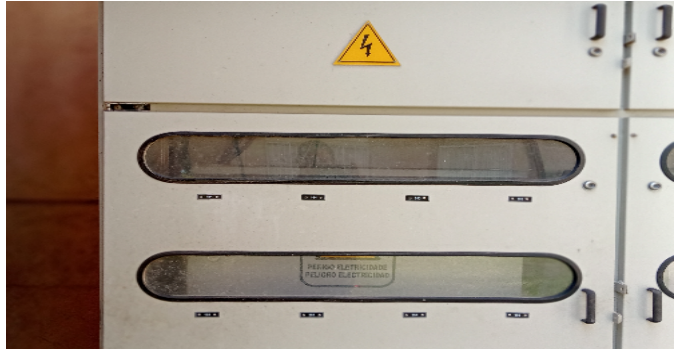
Contador de Energia
