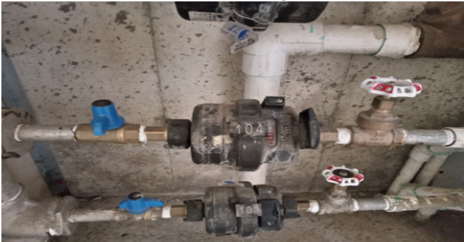
Contador de Agua
