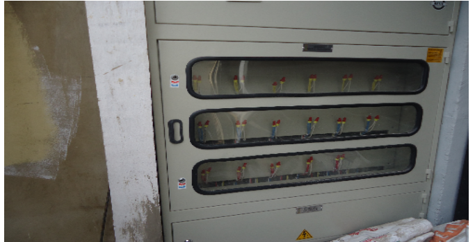
Contador de Energia
