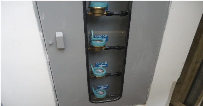
Contador de Agua
