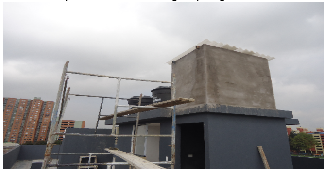
Tanques externos de agua por gravedad CJ
