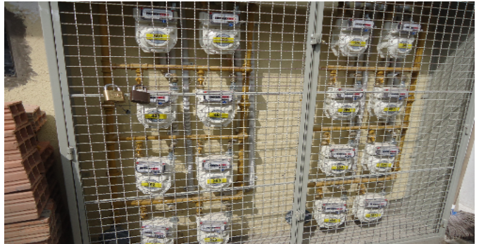
Contador de Gas
