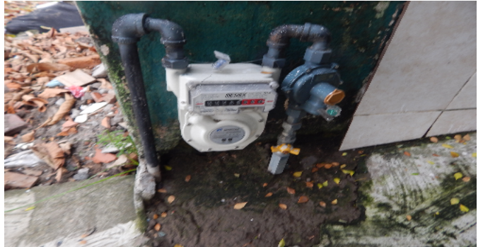
Contador de Gas
