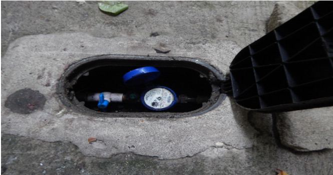
Contador de Agua
