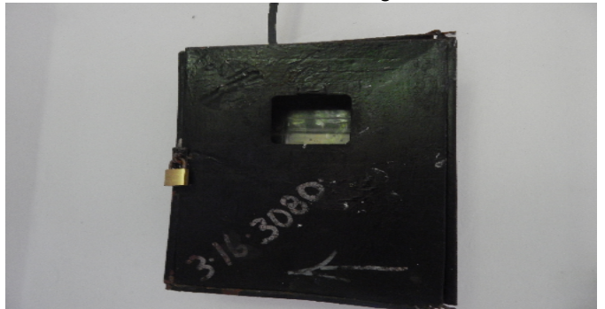
Contador de Energia
