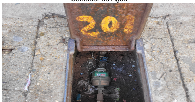
Contador de Agua
