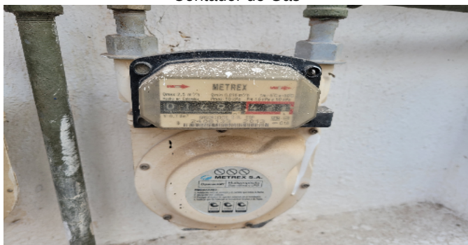
Contador de Gas
