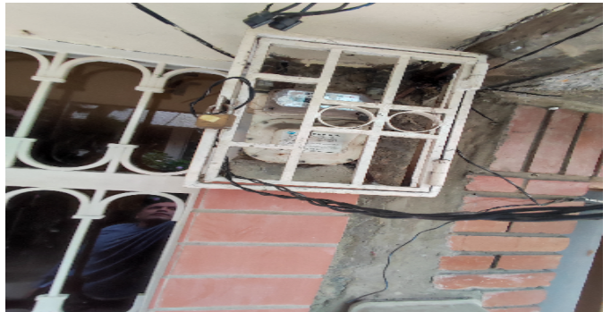
Contador de Gas
