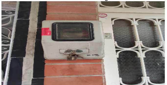
Contador de Energia
