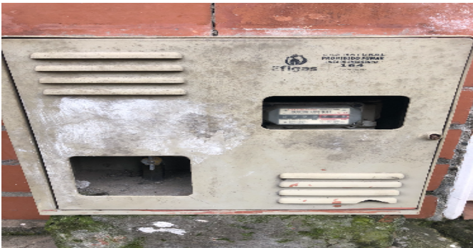
Contador de Gas
