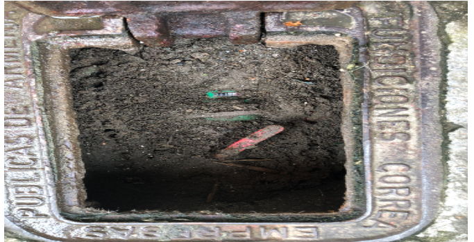
Contador de Agua
