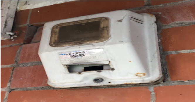
Contador de Energia
