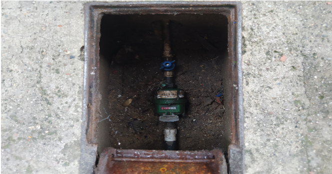
Contador de Agua
