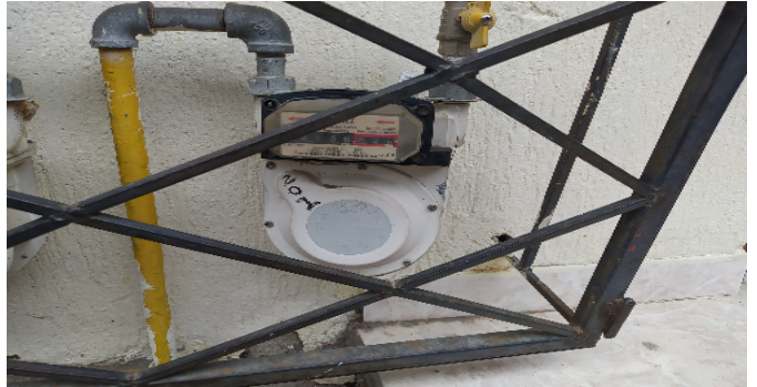
Contador de Gas
