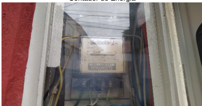
Contador de Energia
