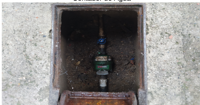
Contador de Agua
