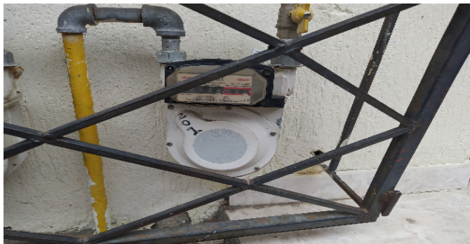
Contador de Gas
